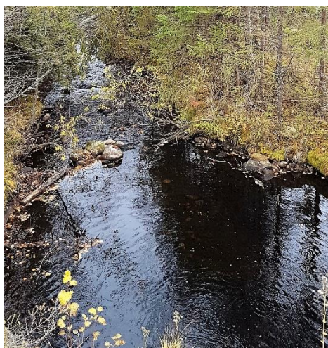
Foton uppifrån vägen: Före åtgärd: En djup håla har bildats vid trummans utlopp, vid låga flöden blir trumman ett vandringshinder.
