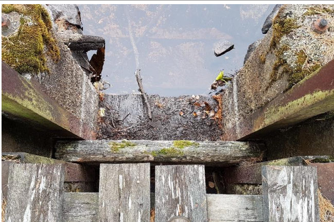
Okt 2016 Sjöns nivå några cm under dämningens gräns, karftigt läckage under betongplattan
