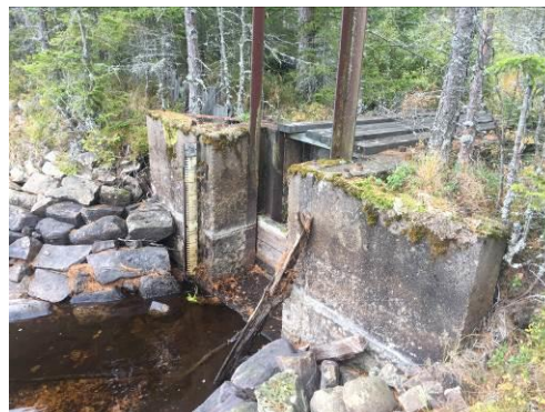
Figur 3. Älgsjöns reglerdamm sedd från uppströmssidan. På grund av läckage och låg vattenföring ligger vattennivån under dammens tröskelnivå. Bilden tagen 161013.
